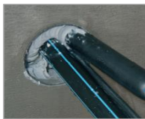
Kein Wassereintritt mehr
