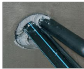
Kein Wassereintritt mehr
